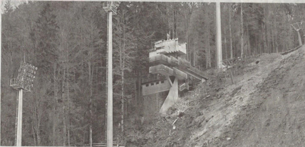
Bei dem Skiflugschanzen-Einsatz handelte es sich insgesamt um 360 t Stahlbetonabbruch sowie 30 t Holz und Stahlteile. FOTO: A. SCHENK
